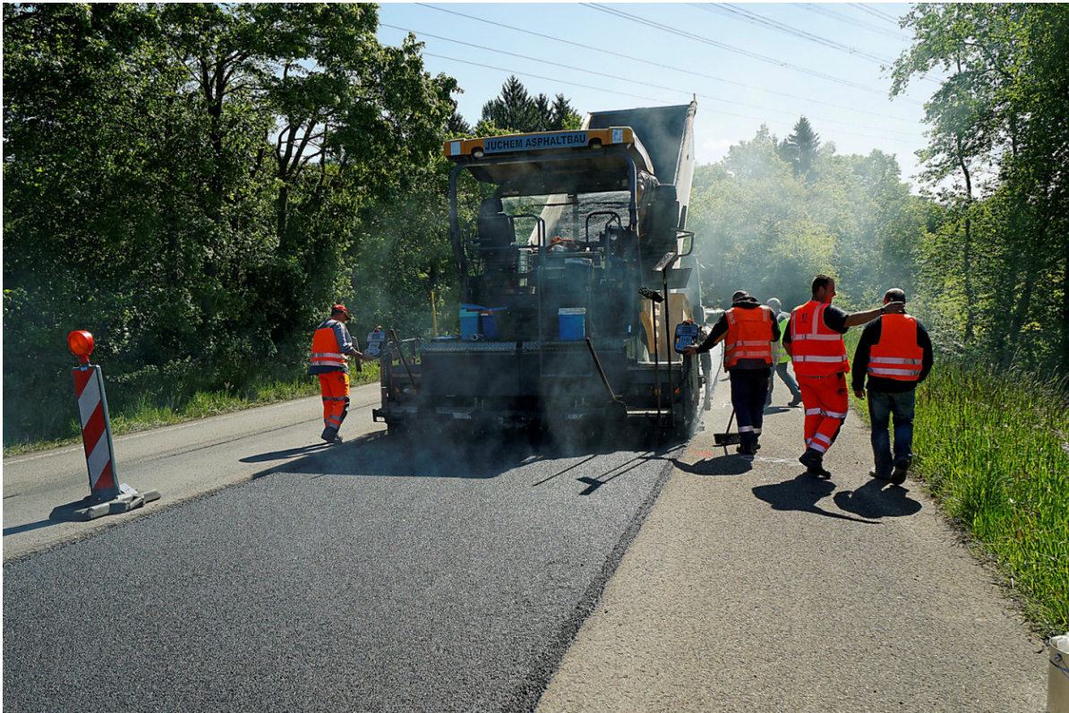
Bild 7: Aufgrund der Verkehrssituation bestand bedauerlicherweise nicht die Möglichkeit einer Vollsperrung. Einbau Asphaltbinder, 1. BA, RF Dagstuhl
