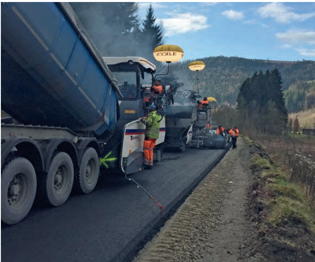
B294 Höfen: Einbau von gummimodifizierten Asphalten SMA 8 S und AC 16 B S in Kompaktbauweise (Quelle: Eurovia)
